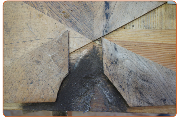
Abgelöste Marketerieteile an einer langfristig vernachlässigten Stelle mit starker Verschmutzung unter dem Furnier. Schloss Ludwigslust. Foto: Atelier Pucalka, Potsdam.
