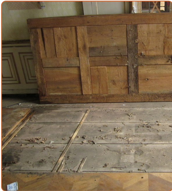
Demontierte Parketttafel, unter deren sich die ursprünglichen Unterlegeleisten und der Blindboden befinden. Originalzustand, Schloss Ludwigslust Foto: Akanthus Restaurierungen GmbH, Eberswalde
