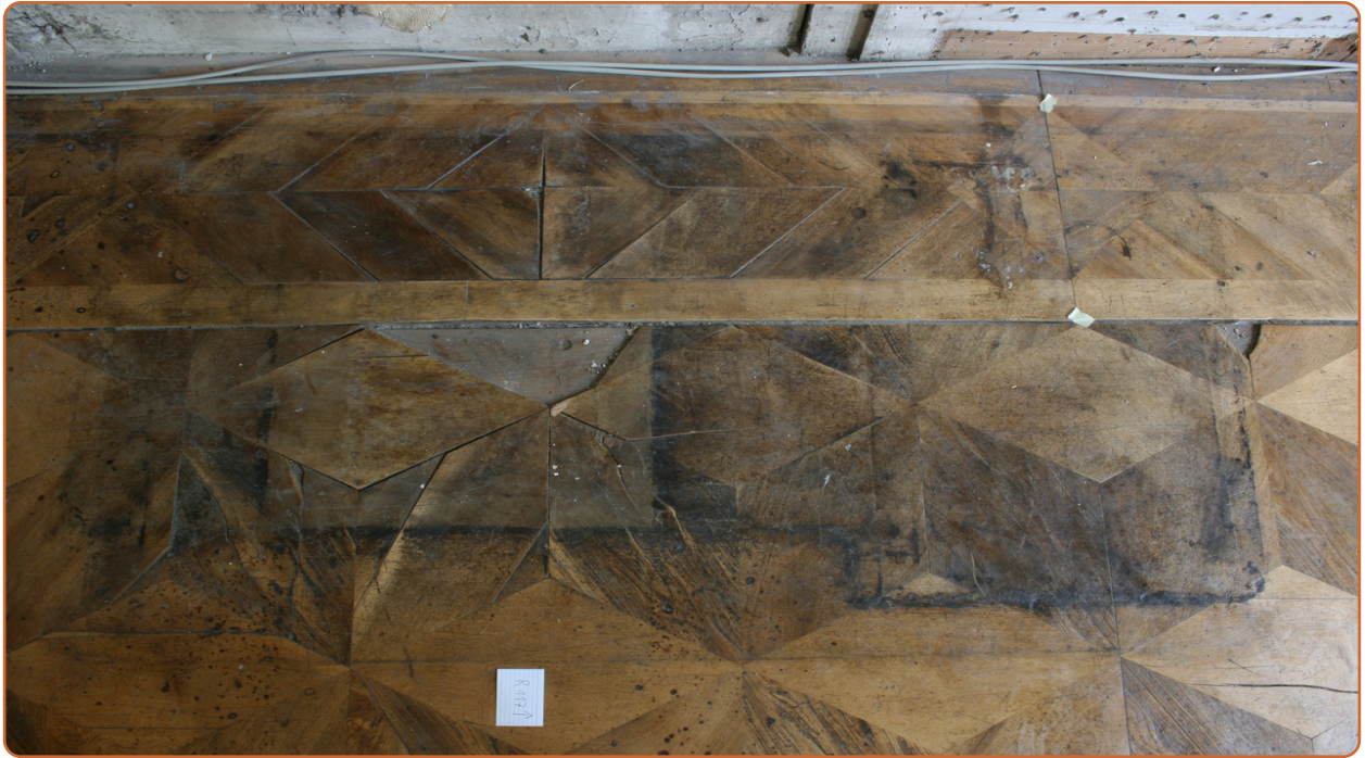
Langfristig vernachlässigter Boden. Teile der Intarsie fehlen oder stehen so hoch ab, dass ein sofortiges Abbrechen und Verlust droht. Schloss Ludwigslust. Foto: Atelier Pucalka, Potsdam.
