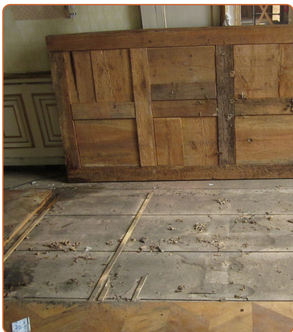
Zvednutá parketa, pod kterou se nacházejí původní podkladové lišty a prkenná podlaha. Původní situace. Zámek Ludwigslust. Foto: Akanthus Restaurierungen GmbH, Eberswalde.
