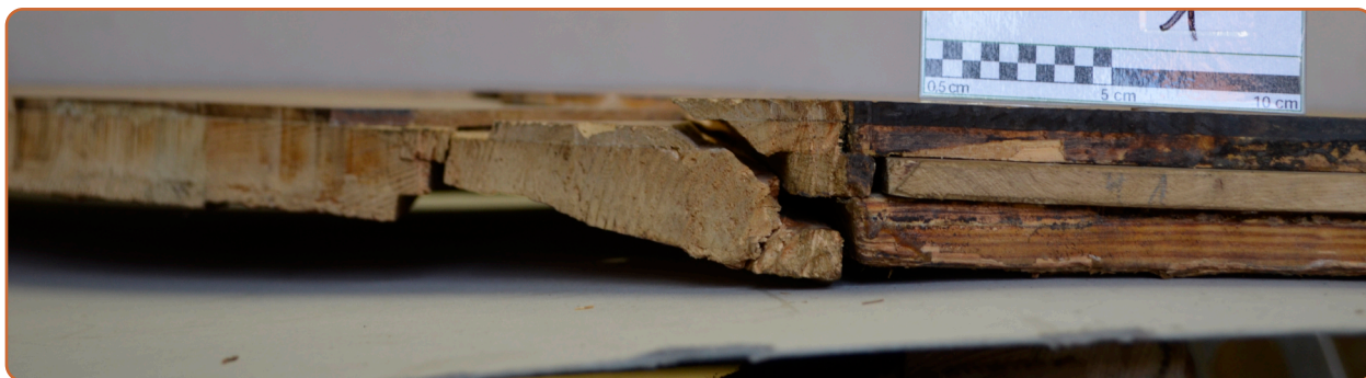
Roztržený rám parkety a poškozená intarzie. Takové poškození může být způsobeno nedostatečným podložením parkety v namáhané zóně. Zámek Ludwigslust. Foto: Akanthus Restaurierungen GmbH, Eberswalde.
