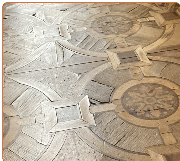
Parketová podlaha s uvolněnými a částečně deformovanými díly intarzie. Nepochozí zóna, zámek Schwerin
