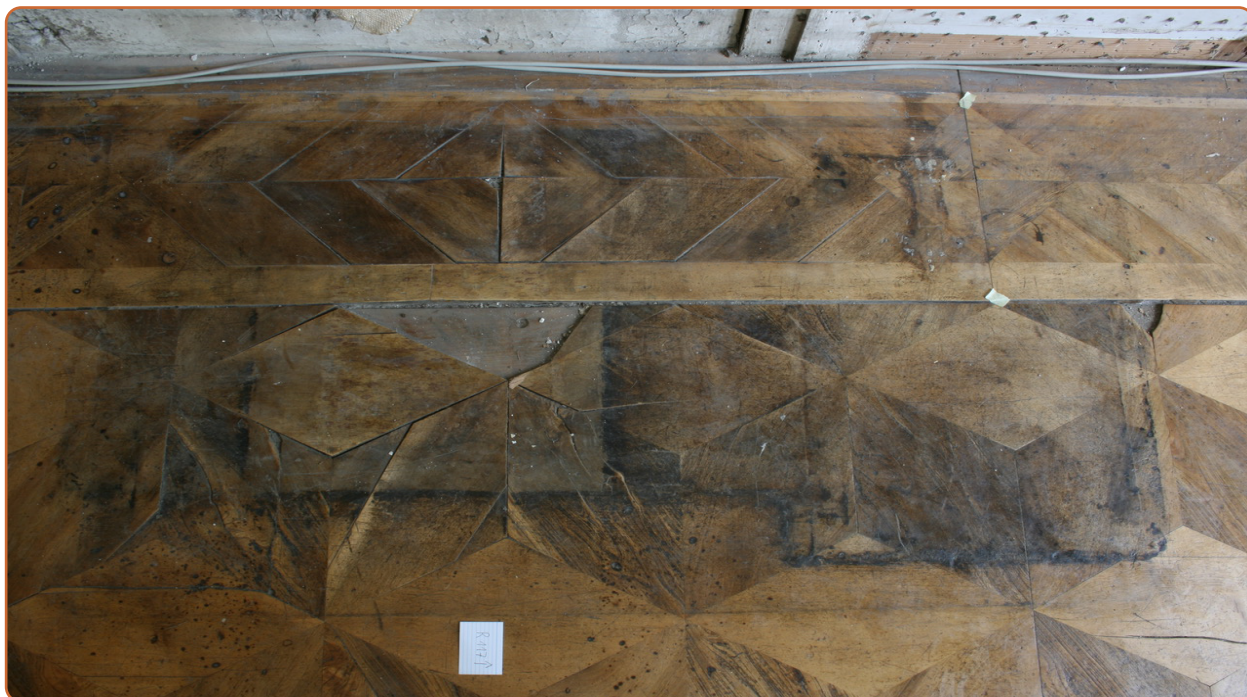
Dlouhodobě zanedbaná podlaha. Části intarzie chybí nebo odstávají tak vysoko, že bezprostředně hrozí jejich odlomení a ztráta. Zámek Ludwigslust. Foto: Atelier Pucalka, Postupim
