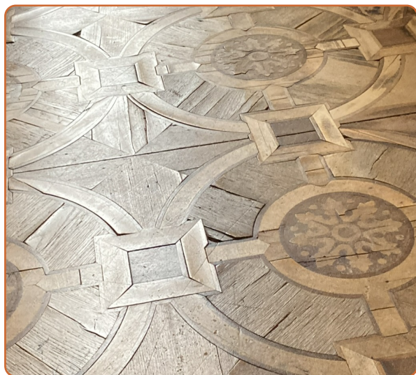
Parquetová podlaha s uvolněnými a částečně deformovanými díly intarzie. Nepochozí zóna, zámek Schwerin
